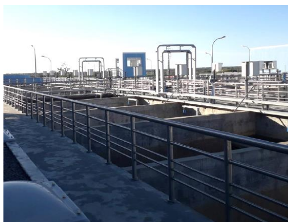
Figura 4. Vista da ETA de Xangongo
