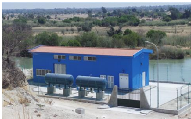
Figura 3. Estação de captação no Rio Cunene
