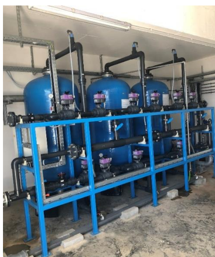
Figura 8. Bateria de filtros pressurizados
