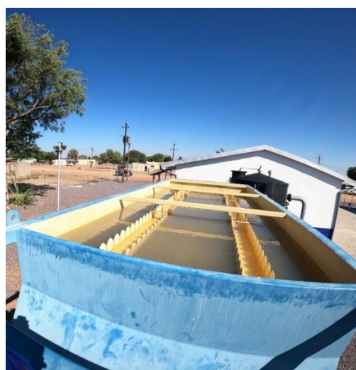
Figura 9. Decantador gravítico de Calueque
