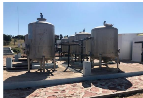
Figura 7. Filtros da ETA de Cahama
